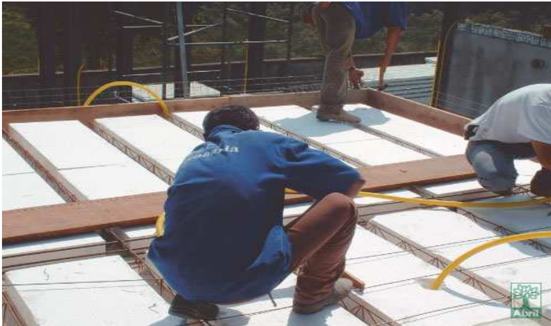
A laje de isopor recebeu uma camada de concreto (4 cm), aplicado de forma tradicional.
